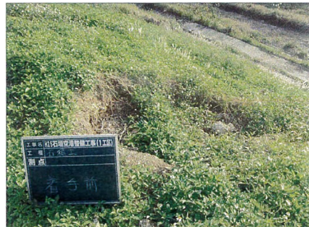
図1 新石垣空港の法面が陥没。開港後半年以内に、空港の法面が6箇所にわたって陥没した。
